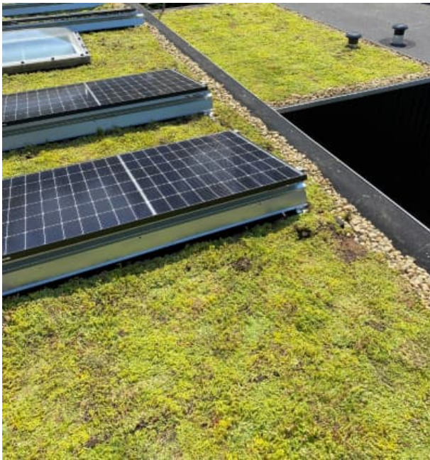
Sedumdak rondom zonnepanelen
